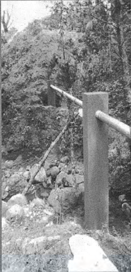
Paso de Zajón en Línea de Conducción en Nva Esperanza
