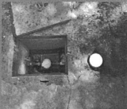
Medidor de Agua
