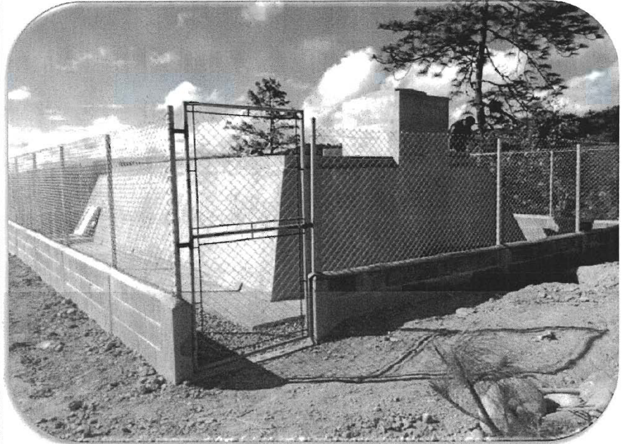
Tanque del proyecto de agua potable de la comunidad de Nueva Esperanza
