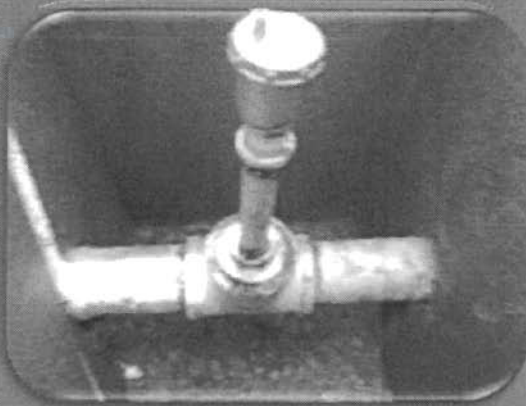
Válvula de aire dentro de la caja de protección
