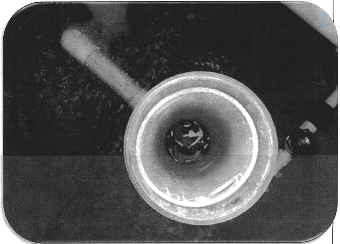
Hipoclorador instalado en San José Nueva Esperanza
