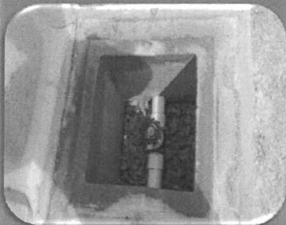
Válvula de compuerta en red de distribución
