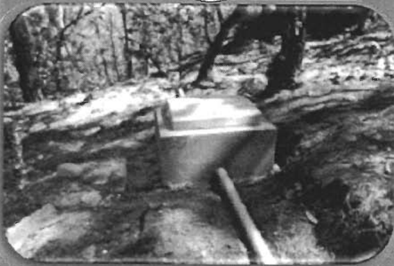
Caja de protección válvula de aire
